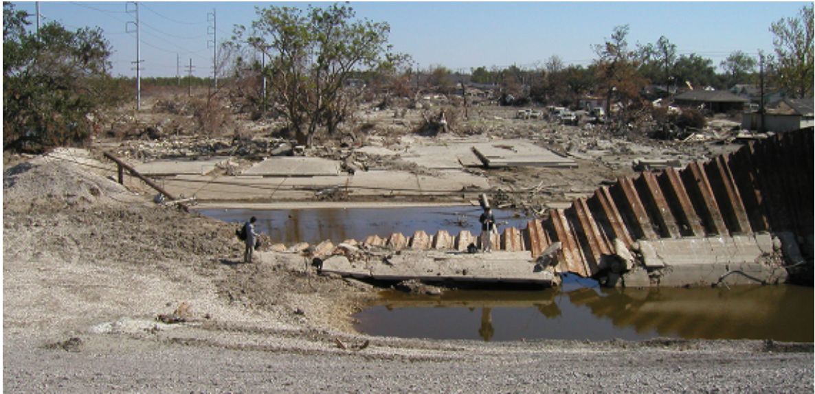
写真— 2 9th Ward の破堤現場
